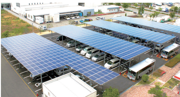
▲神戸本社の駐車場に設置した太陽光パネル
