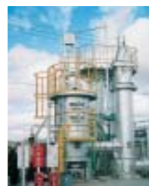
再生プラント工場
