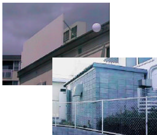
室外機の騒音対策。屋上、防音壁の設置や機械室を設けることで近隣への騒音に配慮しました。
