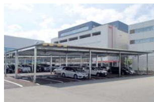
(株)トーホー本社駐車場の太陽光パネル
